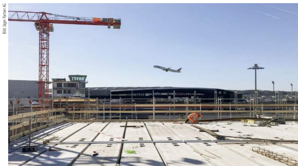
Nach der Montage der vorfabrizierten Deckenelemente ist der Rohbau für das nächste Stockwerk des GSA fertig. Dank modularer Bauweise wird der enge Zeitplan für den Hochbau eingehalten.
